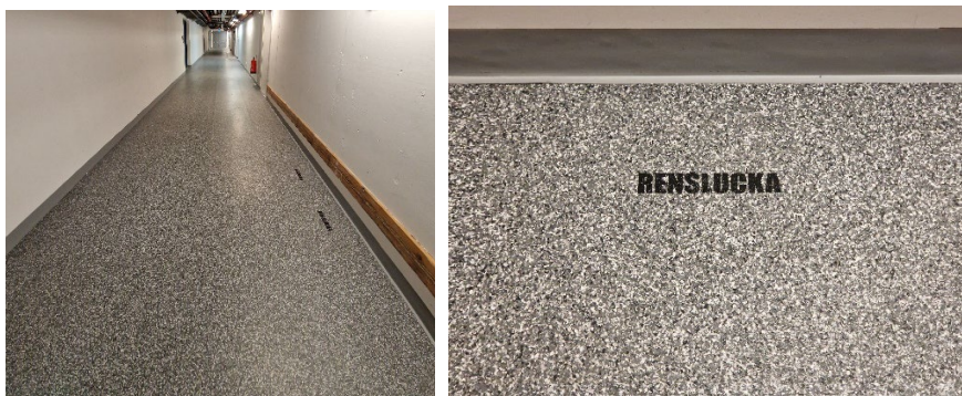
Exempel på markering av dolda funktioner under löst golv. Alternativ till skylt ovan sockel. Fotografi M. Ström Hugner Locum
