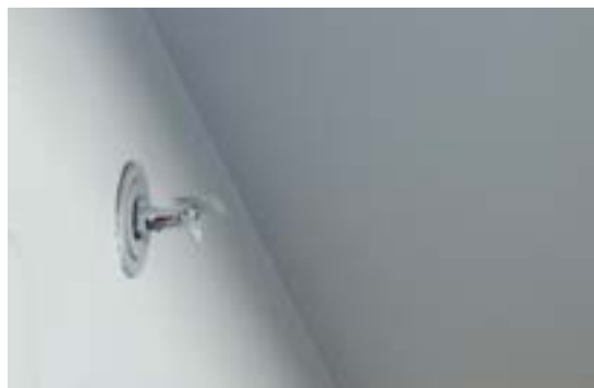
Sprinkler på vägg
