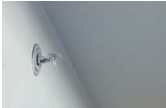
Sprinkler på vägg
