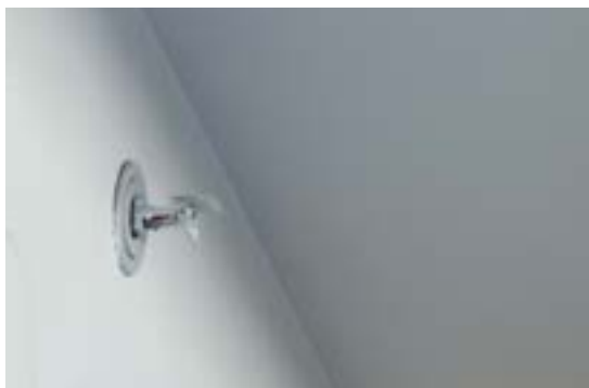
Sprinkler på vägg
