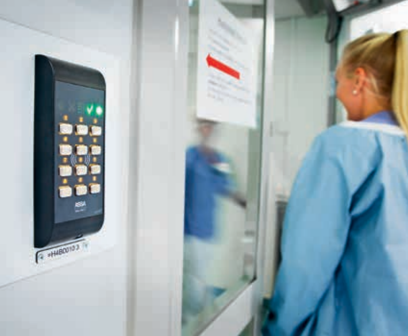
Södersjukhuset ska få ett nytt passagesystem. Säkrare, bekvämare för personalen och enklare att administrera. BILD OLOF HOLDAR
