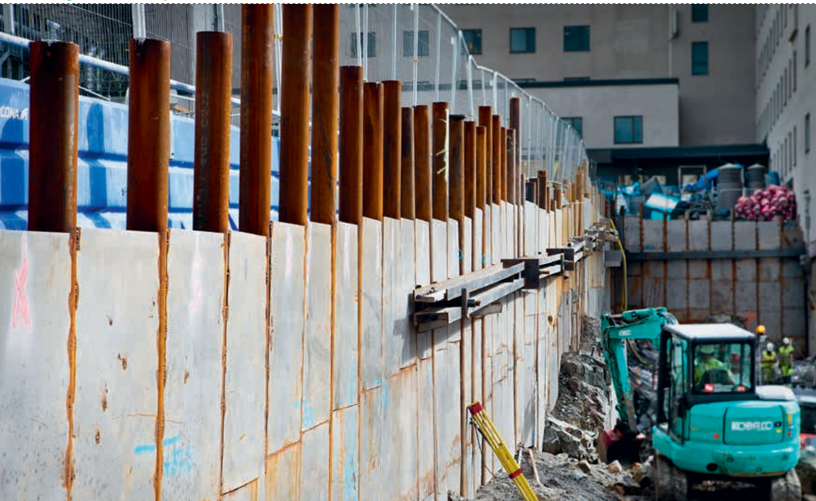
Att sponta är att bygga en säkerhetsvägg vid schaktningsarbeten. Vilken typ av spont avgörs dels av vad sponten ska stoppa, dels också av vilka verksamheter som finns i närheten eftersom olika metoder för spontning låter olika mycket. BILD OLOF HOLDAR
