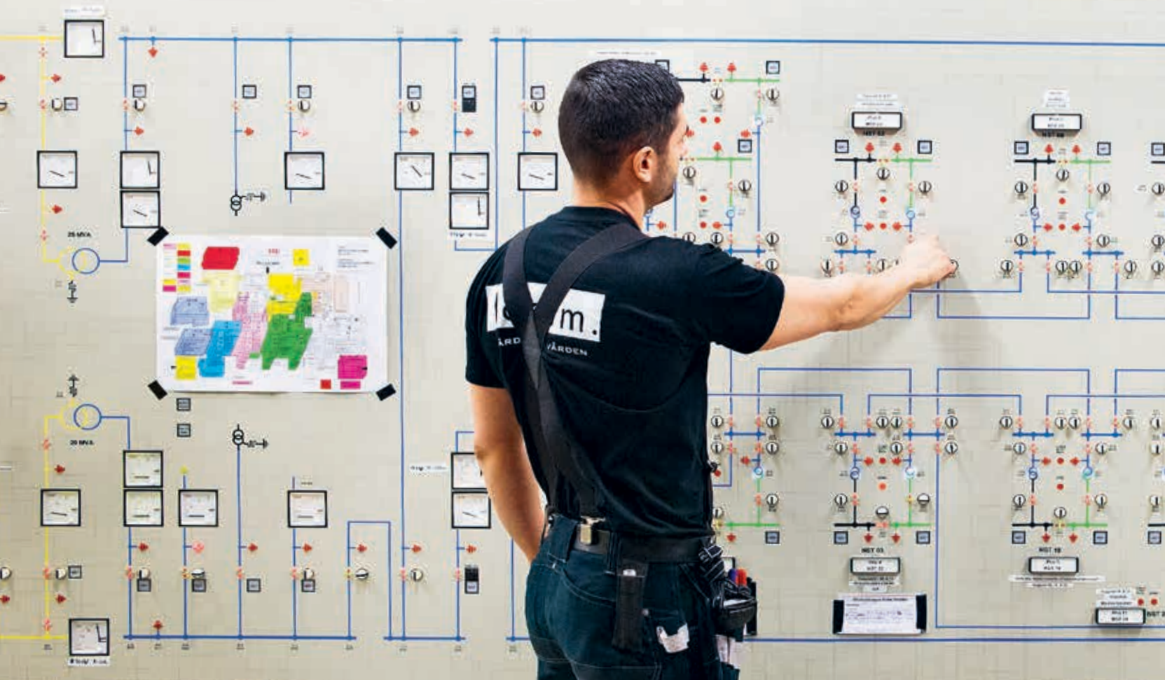
På kontrolltavlan kan Locums personal överblicka sjukhusets hela kraftförsörjningssystem och larma om det skulle uppstå en driftstörning. Under perioder när kraftsystemet testas bevakas tavlan dygnet runt.
