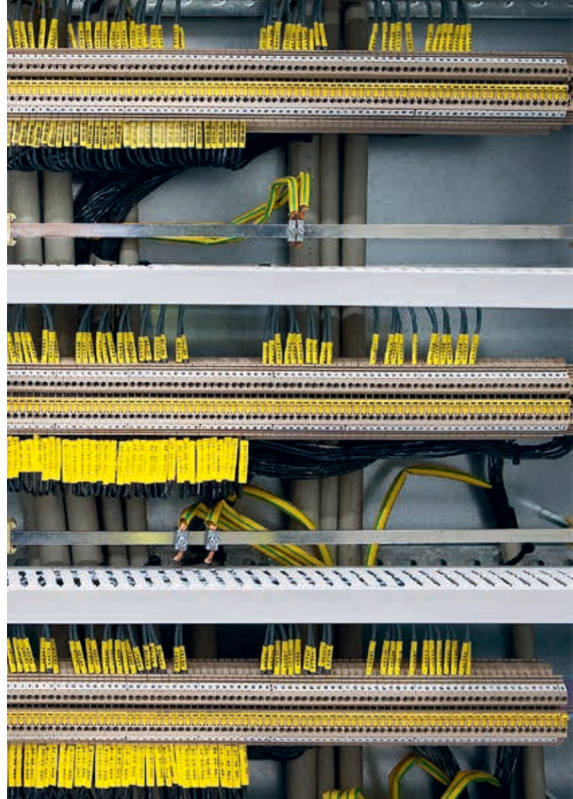
Kommunikationen mellan mottagningsstation och nätstationer går via ett korskopplingskåp.
