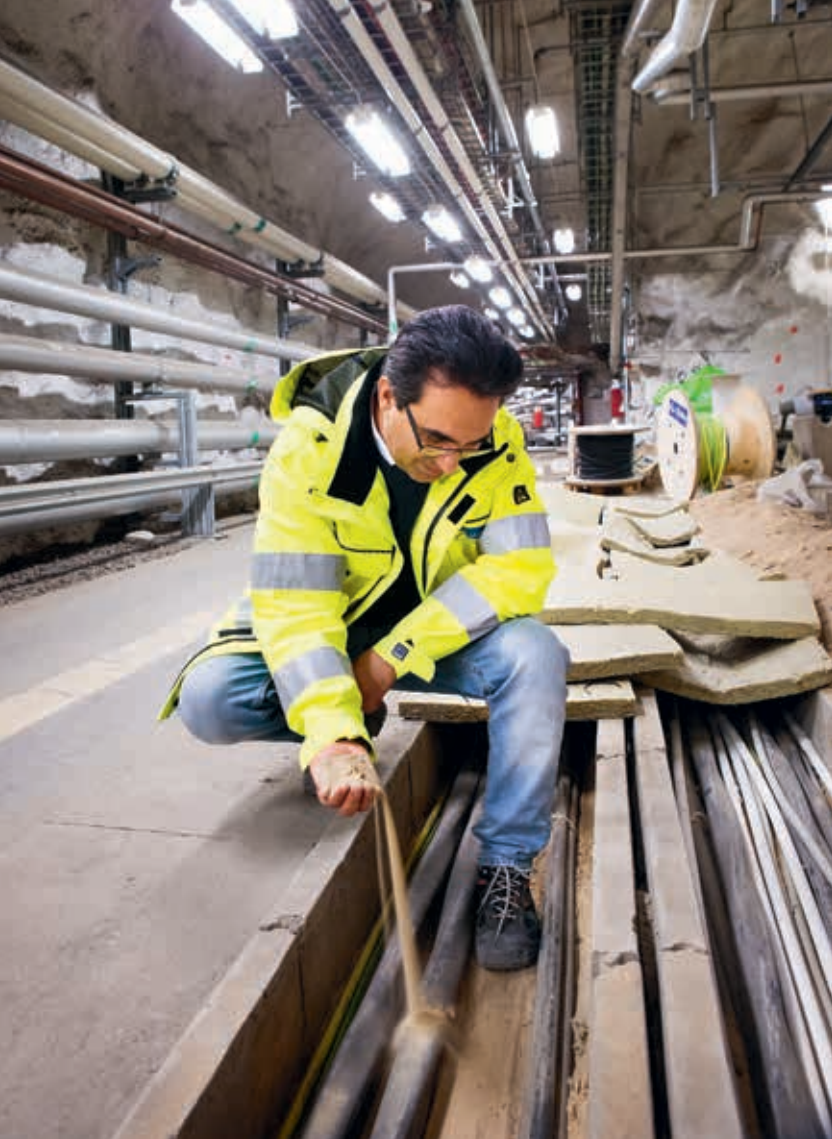
Valid Hatami, projektledare för Södersjukhusets nya kraftförsörjningssystem, kontrollerar kablar som går genom en sandbädd i golvet för extra brandskydd.
