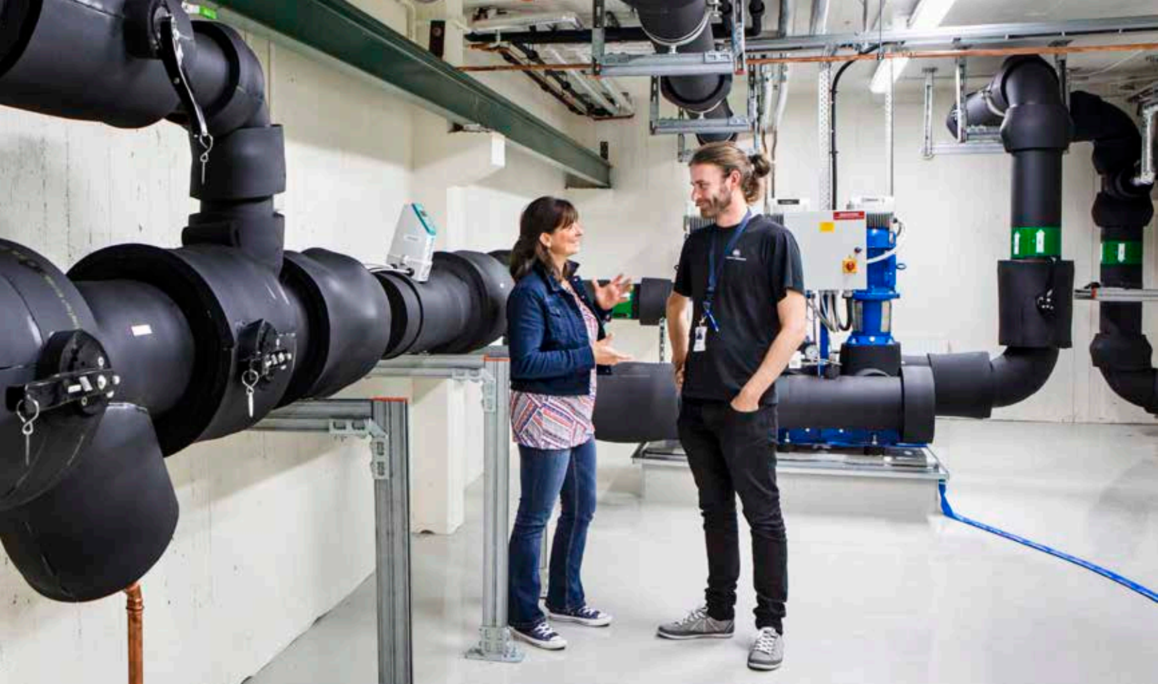
Locums Véronique Maussier och Fredrik Magnusson, drifttekniker vid St Görans sjukhus, vid en av de ledningar som förser St Görans sjukhus med vatten.
