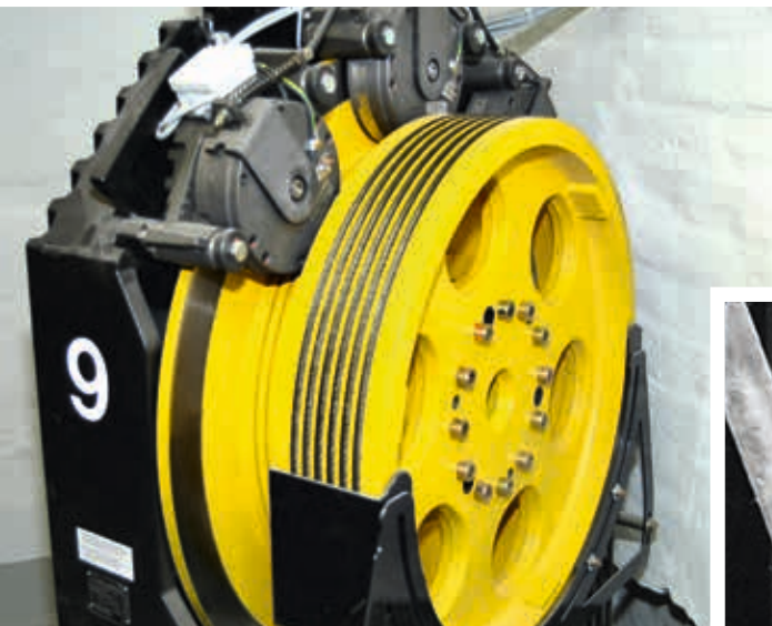
Topmodern växellös hissmaskin.
