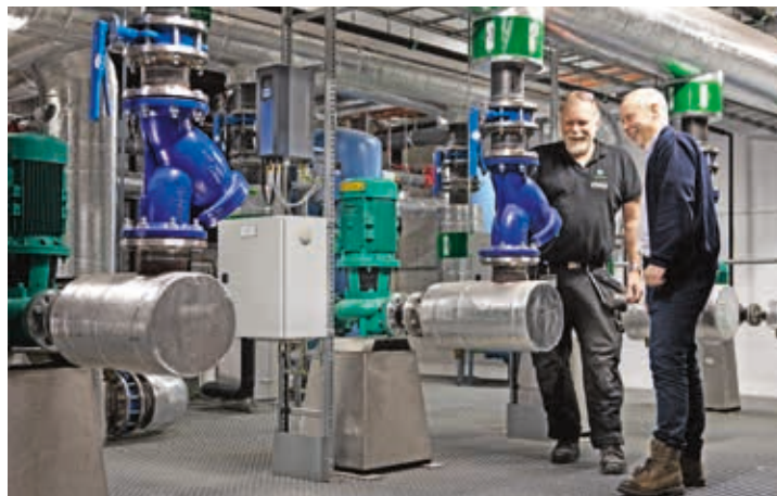
Jan Ågren, Locums driftcontroller i Södertälje och drifteknikern Thomas Glantz jobbar dagligen med att se till att sjukhuset kan fungera utan störningar.
