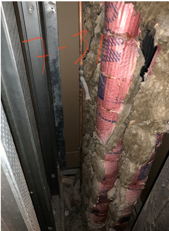
Bild 6. Plan 07, schaktläge 31. Tappvattenledningar med trasig och utan isolering.
