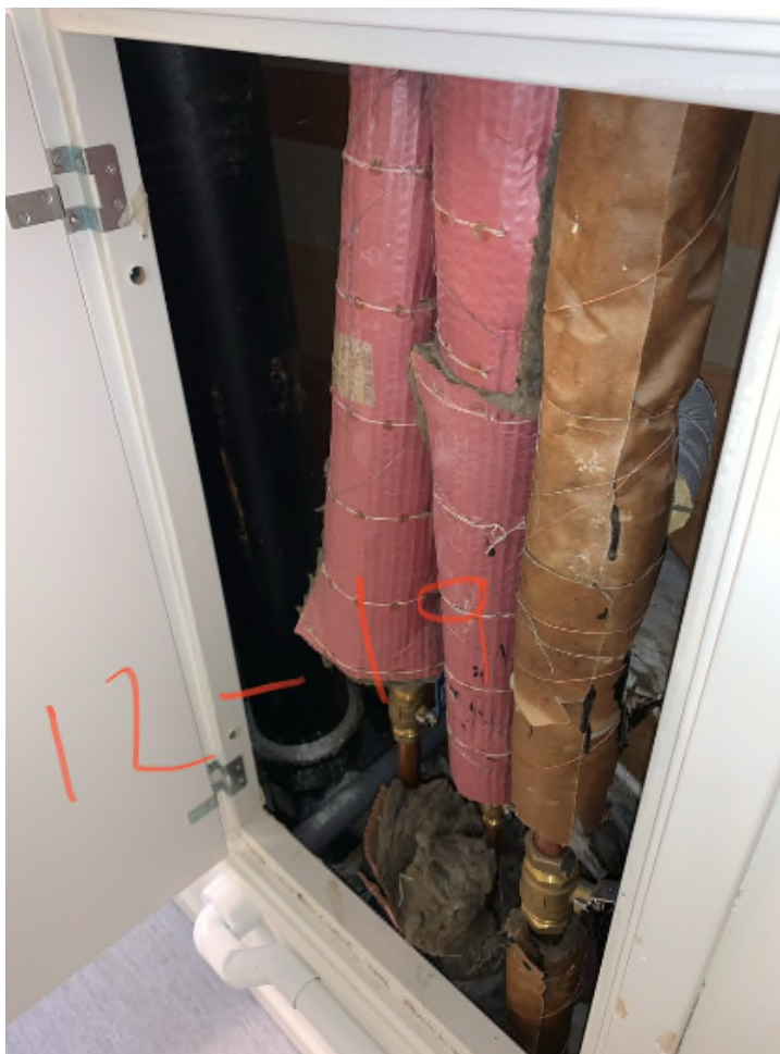
Bild 10. Plan 12, schaktläge 19. Varmvattenledningar som är isolerade med rosa papp med brun baksida utan asbestinnehåll. Kallvattenledning med brun papp innehåller asbest.
