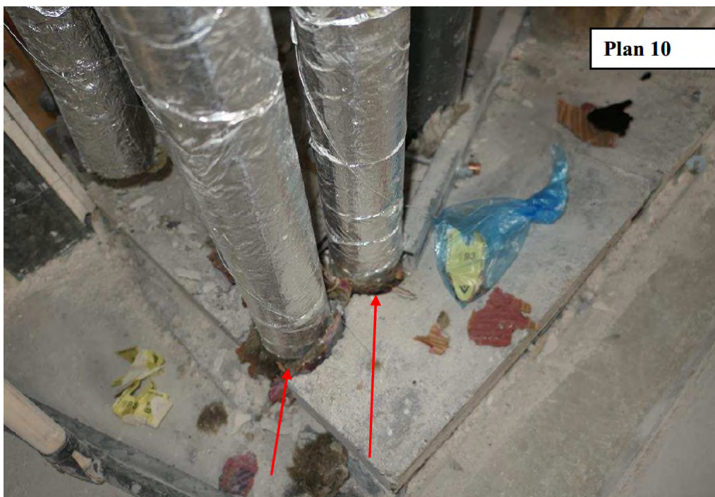
Bild 11. Rörschakt plan 10. Rester av gammal rörisolering i bjälklagsgenomföringar.
