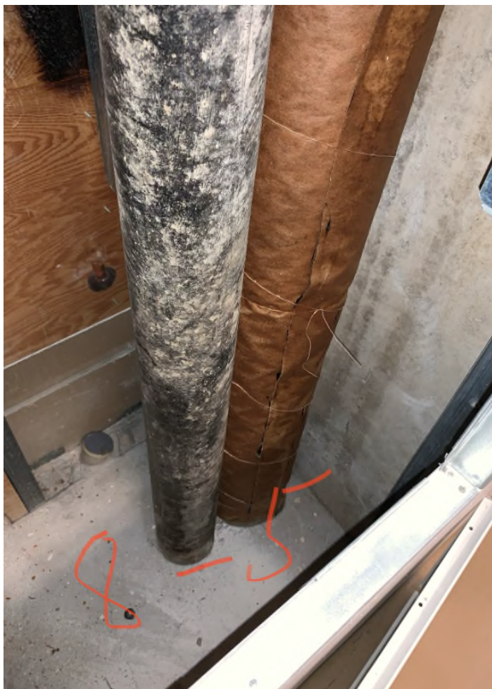
Bild 9. Plan 08, schaktläge 5. Spillvattenstam i gjutjärn utan isolering. Dagvattenstam med asbestinnehållande papp.
