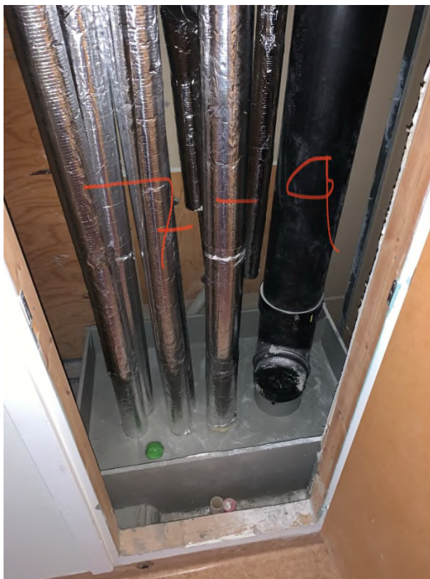
Bild 7. Plan 07, schaktläge 9. Tappvattenledningar med ny isolering.
